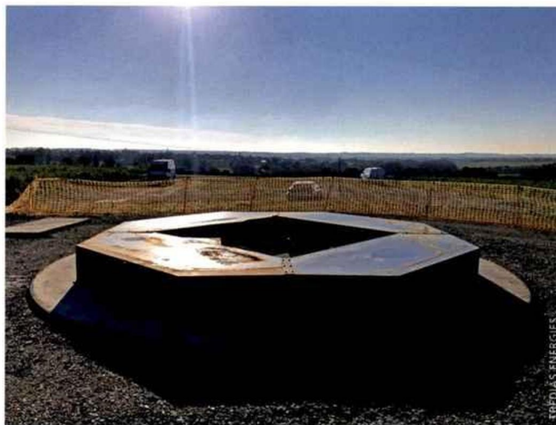
Les fondations du parc de Trédias ont déjà été construites et les éoliennes achetées. Le préjudice financier est grand.
