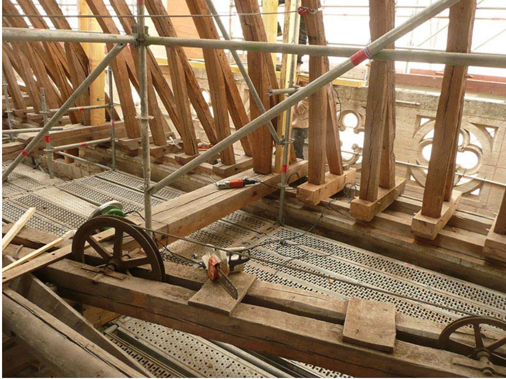
Restauration des appuis de la charpente : les faux blochets moisés (visibles à gauche sur le cliché) ont systématiquement été remplacés par de véritables sabots.
