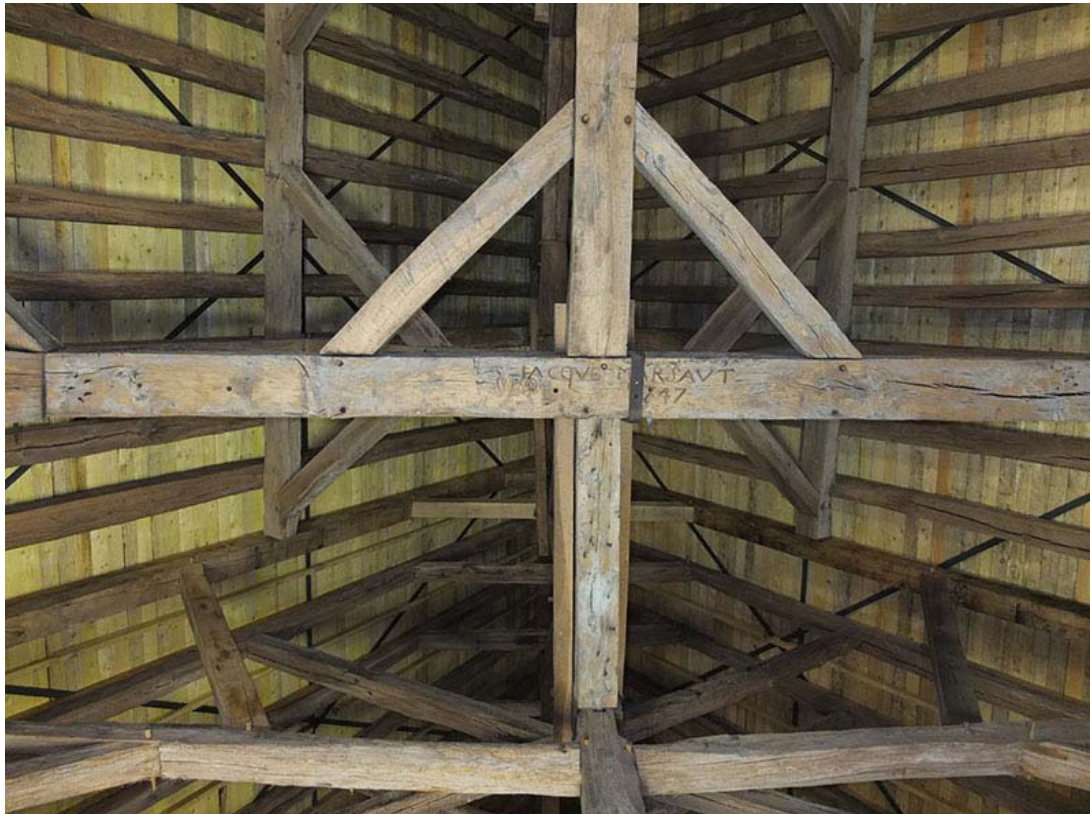
Détail de la charpente restaurée, au droit des travaux du XVIIIème siècle (fièrement signée : « Jacques Marsaut 1747 »). A part la volige, de l'intervention contemporaine, seul le contreventement métallique est visible.
