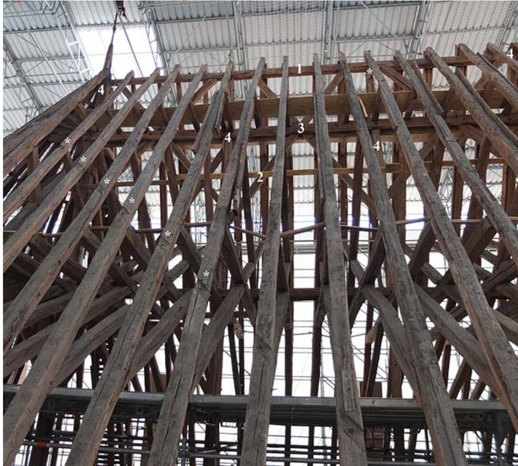
La charpente de la partie droite du chœur, après dépose, après dépose des ardoises et des lattes. Légende : 1, 2 et 3 : ajouts d'un faitage, de croix de Saint-André et de moises longitudinales au XIXème siècle ; 4 : poinçon ; 5 : chevron moisé par côtés et fourré en réutilisant des parties de l'ancien contreventement médiéval) ; * : entailles de l'ancien contreventement visibles sur les poinçons et les faces extérieures des chevrons.
