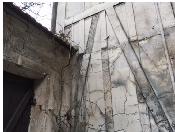
Les faux colombages de l'écurie avant restauration. © A. Randon.
